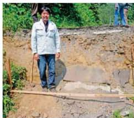
2011年4月11日に起こった地震(震源:福島県いわき市)により出現した断層により寸断された道路
