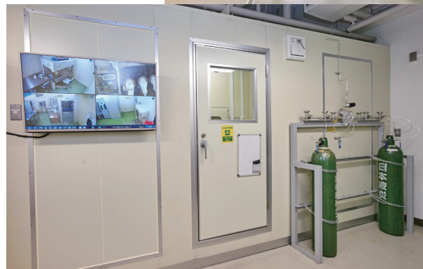
◀クリーンルーム入口に設置されたモニターからは室内の様子が映し出される
